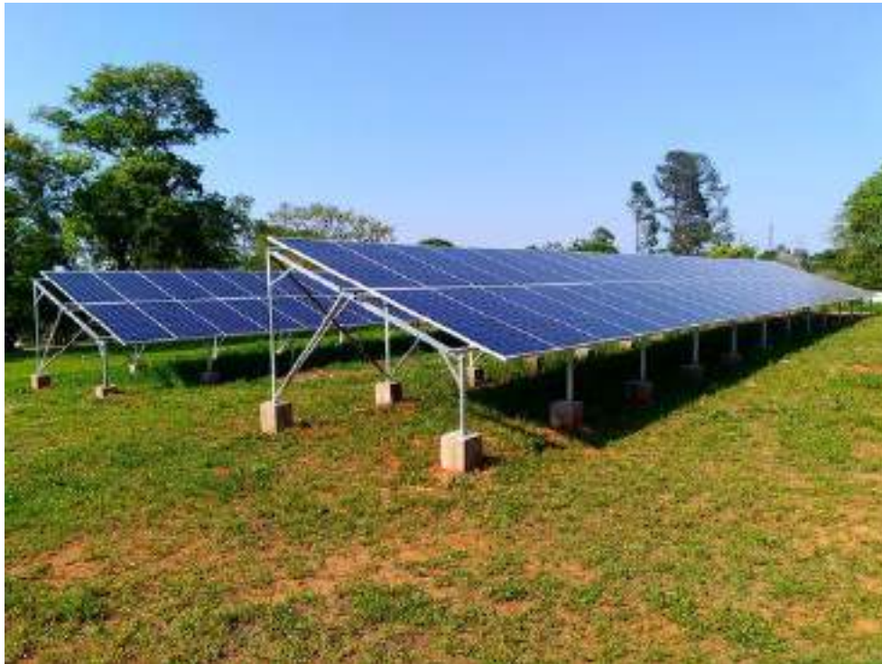
Figura 15: Painéis de energia solar.
